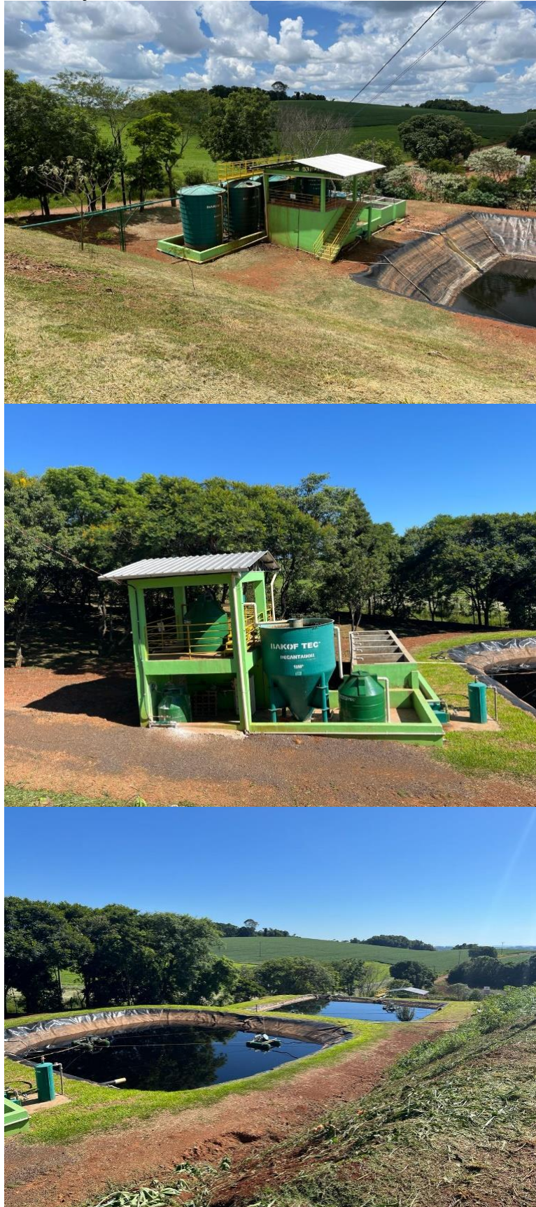
Figura 34: Estação de tratamento do efluente/lixiviado.
